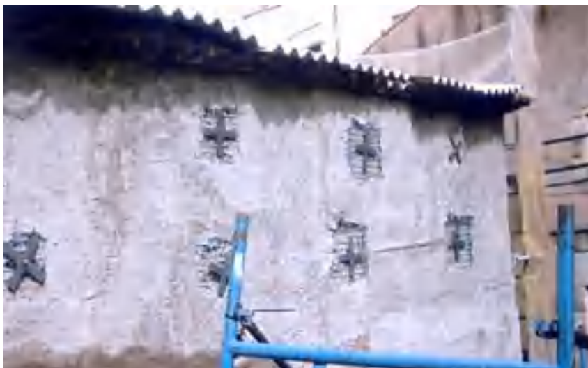
Reforç de la façana posterior amb malla i creuets per sota de l'arrebossat.
