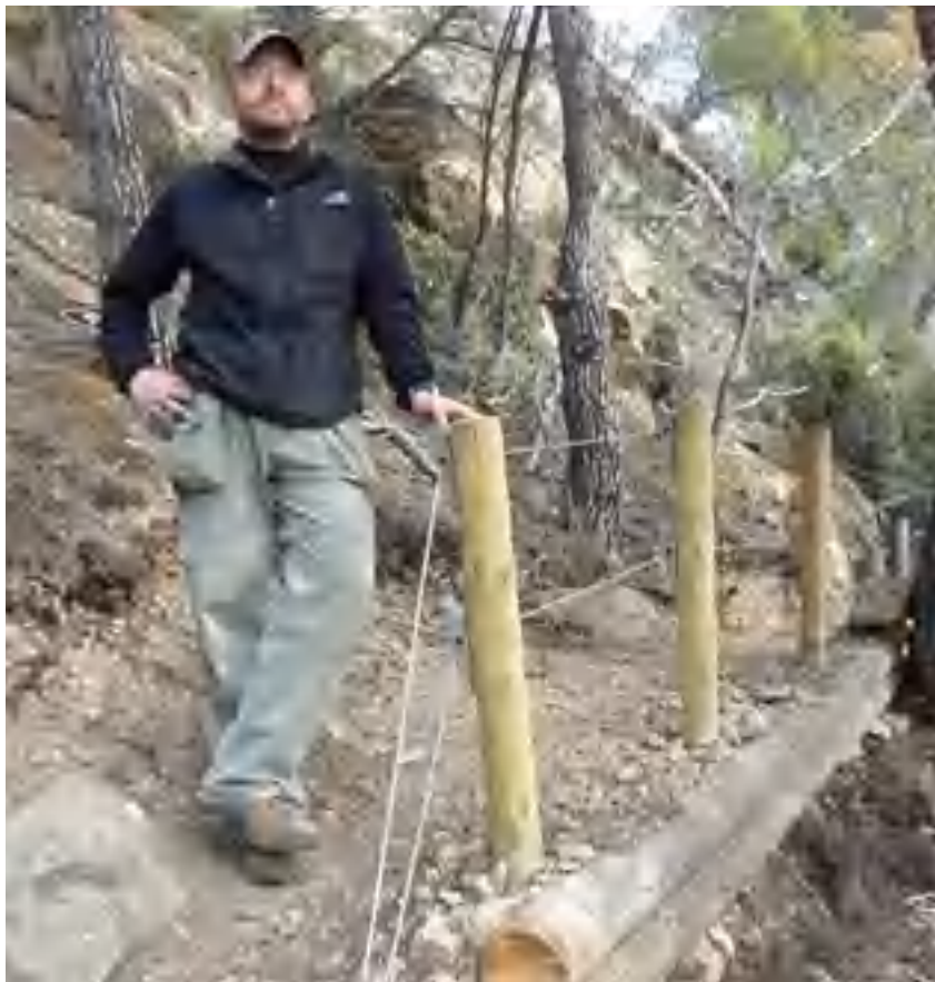
Josep Santané al costat d'una barana confeccionada amb pals de llum i cables elèctrics.
